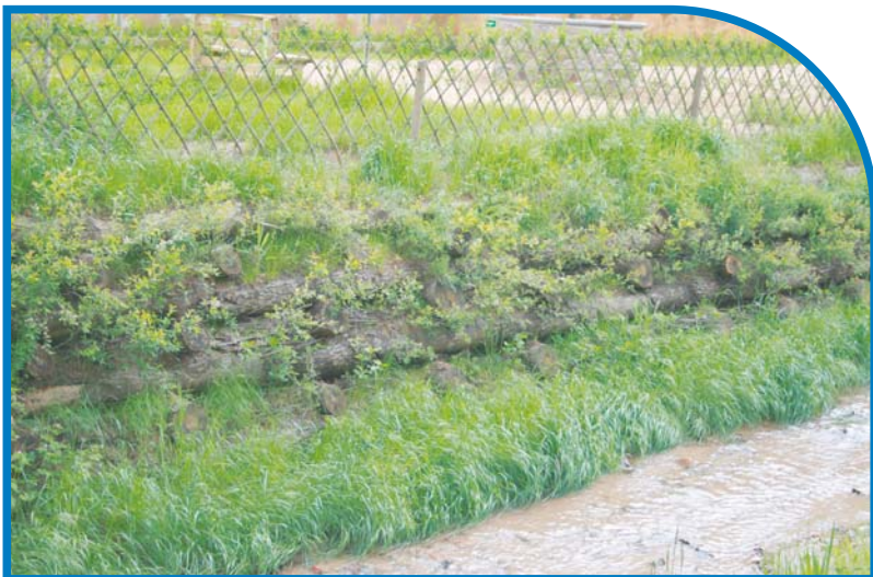
Construcció d'una estructura amb tècniques de bioenginyeria a la riera de Vallicrosa (Sant Hilari Sacalm).
